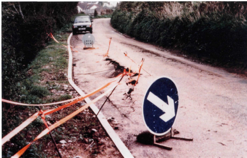
Figuur 16. Schade aan een B-weg als gevolg van ondertunneling (Wilson & Byrnes, 1996).
