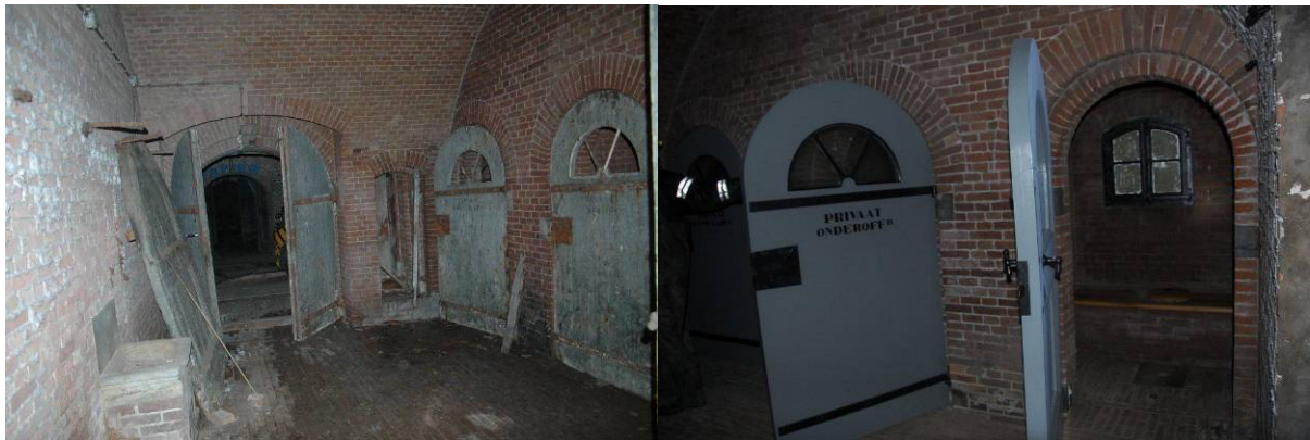
Figuur 3: De privaatdeuren (2 deuren links) waren de belangrijkste overwinteringsplekken. Hier in de oude en de nieuwe situatie. Door een te snelle verandering (alle deuren in een keer vernieuwd) en openstaand, is deze plek nu geheel ongeschikt.
