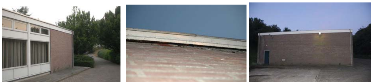
Figuur 17: De zomerverblijfplaats uit 2006 bij loods V (2 paarverblijven in 2009), en de voorjaarverblijfplaats en paarverblijf bij loods O.
