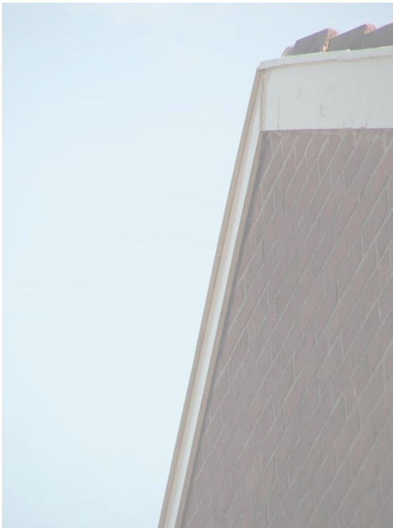
Kierende daklijst (niet gerenoveerd dak; toegang tot spouw)
