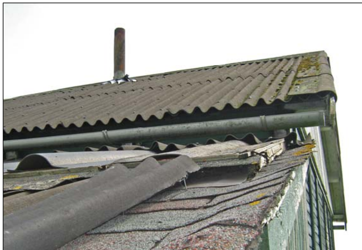
Afbeelding 9. Onder het dak van het te slopen zomerhuisje op locatie B bevindt zich een verblijfplaats (paarplaats) van een ruige dwergvleermuis ( Pipistrellus nathusii ). Foto: R.M. Koelman.
