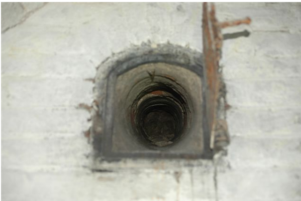
Figuur 3: Een andere verblijfsplek van de kolonie watervleermuizen (in een rookkanaal, de toegang is via buitenom). De binnenzijde hoort gesloten te zijn.
