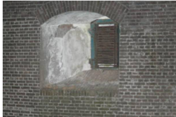
Paarplek van gewone dwergvleermuis achter de los gekomen betonschil van een geschutsvenster.
