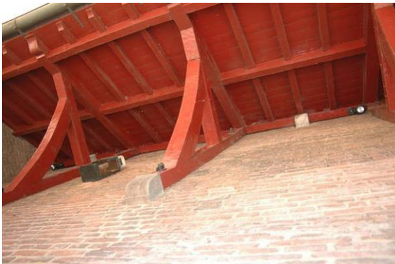
Een paarverblijf op Muider slot, verloren gegaan door plaatsing van verlichting (links onder het afdak).
