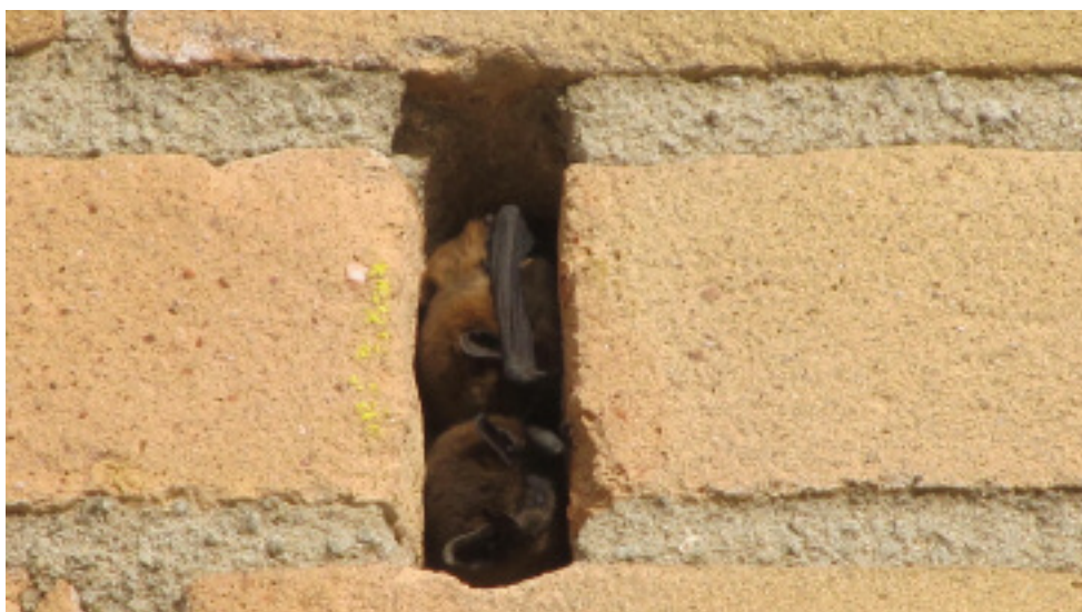
Zonnende dwergvleermuizen in een stootvoeg. Foto Ilco van Woersem
