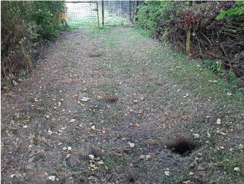
Figuur 1. Het door dassen ondermijnde toegangspad.
