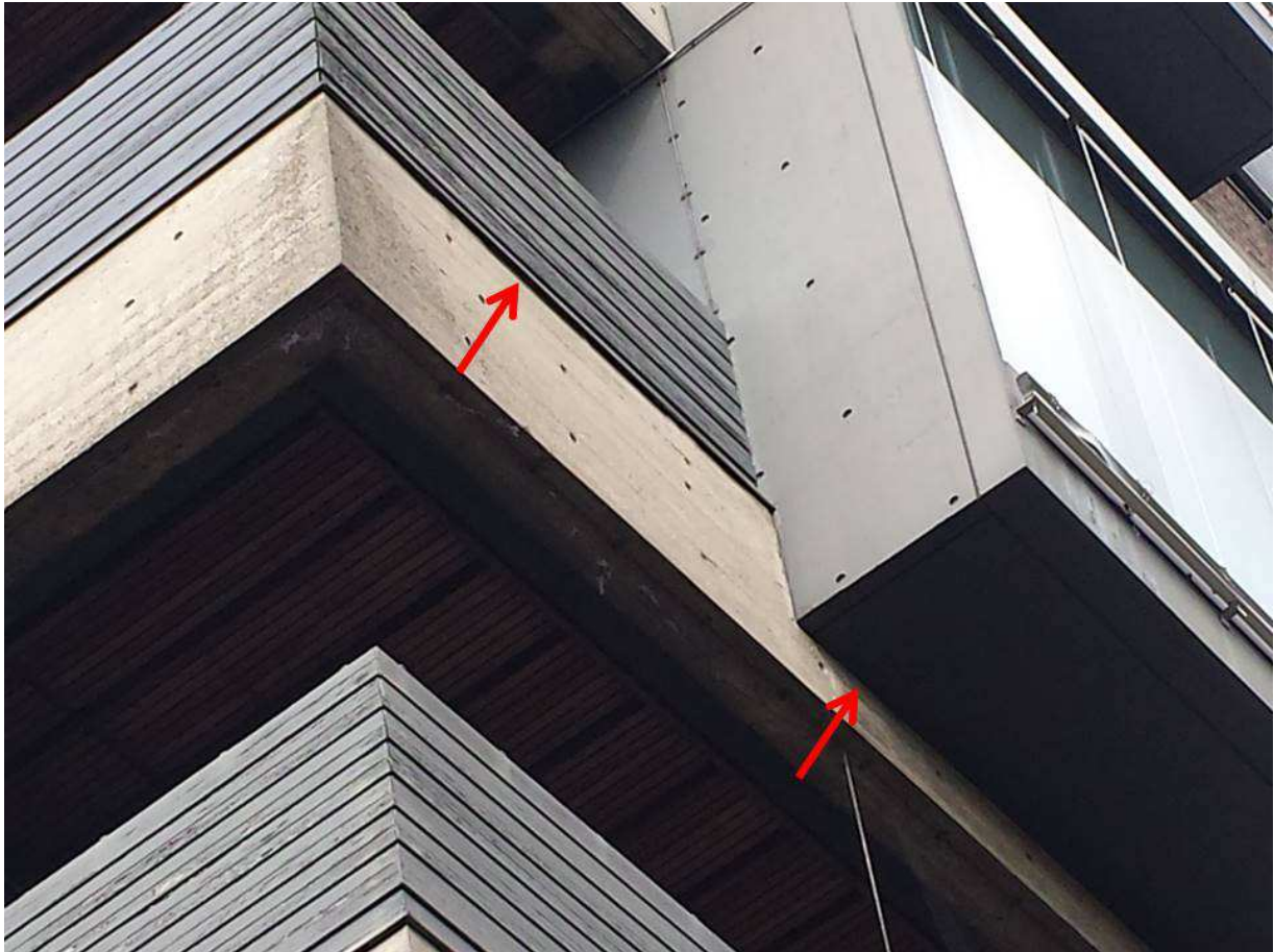
Figuur 2: toegangen onder houten lambrisering rond de balustrade van balkons. Deze situatie is eveneens overall rond het gebouw zo aan te treffen.
