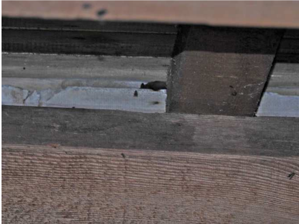
Figuur 9: Een van de wegkruiplekken van gewone dwergvleermuizen in de nok van de warmere traverse, de dwarszolder.
