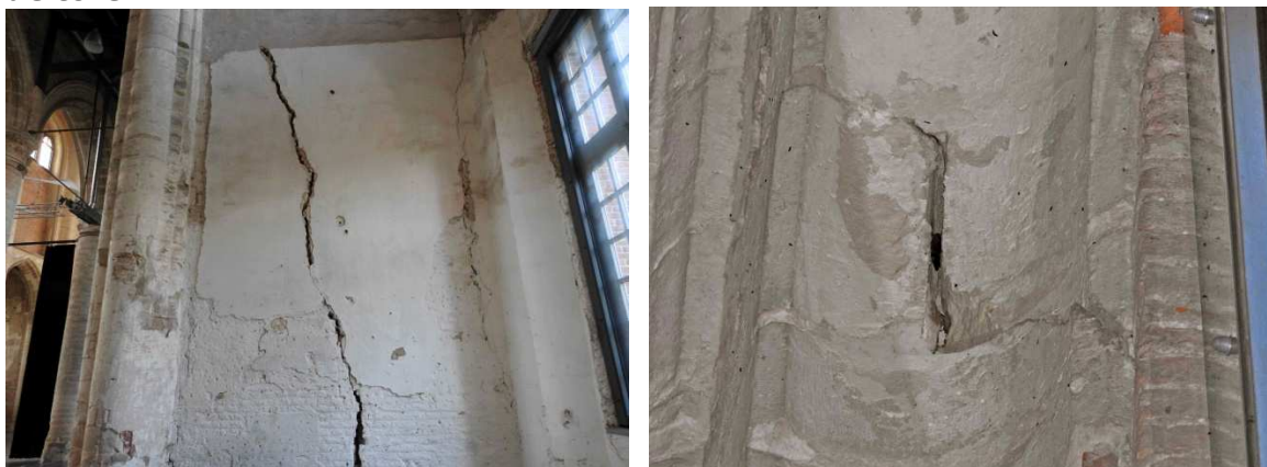
Figuur 5: De scheuren in de dwarsmuurtjes en ornament van raamsparing van het schip; overwinteringsplekken voor solitaire dieren en groepjes gewone dwergvleermuizen.
