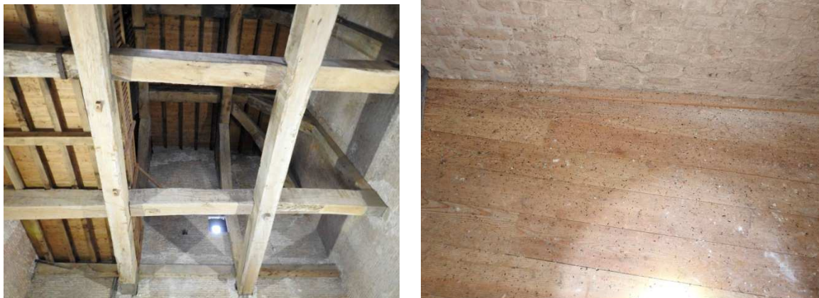
Figuur 4: De balkgaten en balken langs de wand, belangrijke vleermuis winterplekken. Door veel dieren in gebruik gezien de vele keutels op de vloer in de toren.
