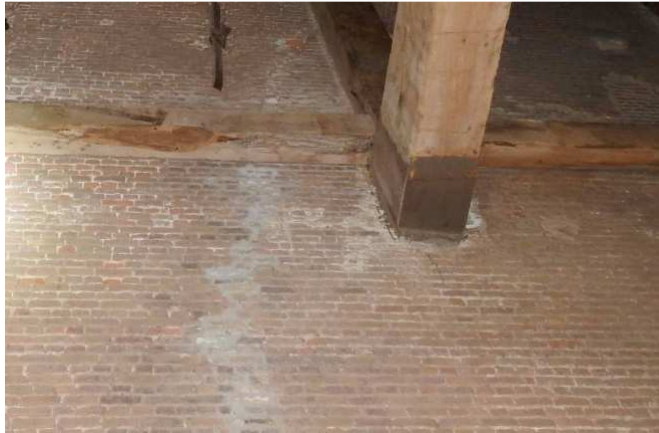
Figuur 19: Bij restauratie werkzaamheden verloren gegane wegkruipplekken, een dichtgezette scheur en dichtgezet balkgat op de 1 e zolder van de toren.
