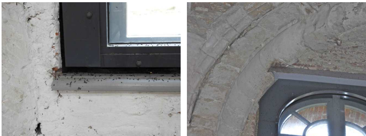
Figuur 17: Gebruik van de raamkozijnen als wegkruipplek. Rechts nog een van de weinige nog duidelijk aanwezige invlieg/ doorkruipplekken (foto van binnenzijde).
